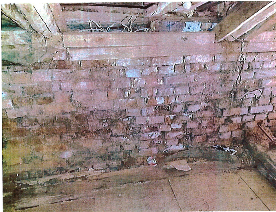
Фото 53. Выпадение цементно-песчаного раствора в горизонтальных и вертикальных швах в уровне чердачного помещения
