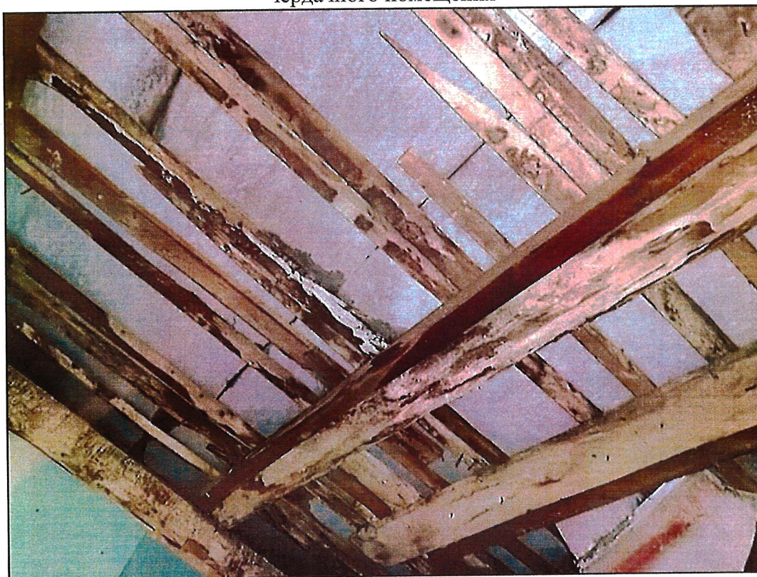
Фото 54. Следы протечек покрытия кровли
