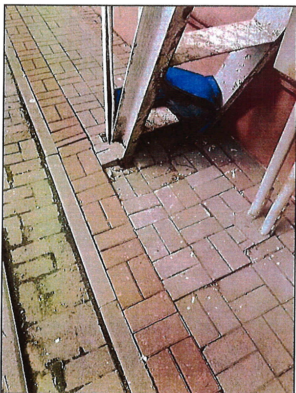
Фото 41. Проседание отмостки из бетонной плитки
