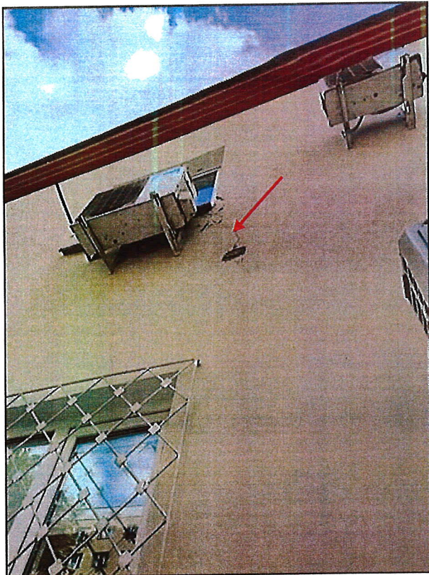
Фото 43. Трещина, шириной раскрытия до 3мм по оси «Б» в осях «1-2»
