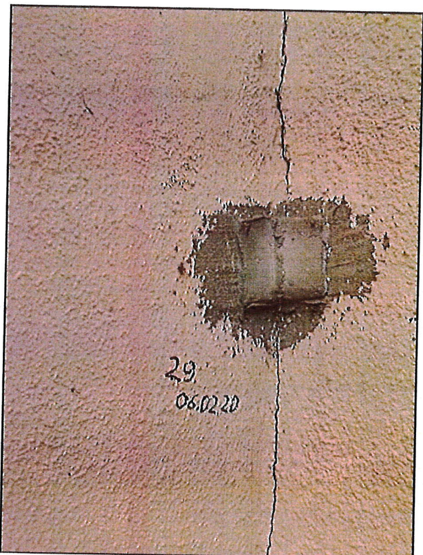
Фото 49. Трещина, шириной раскрытия мм по оси «Б» в осях «4-5»
