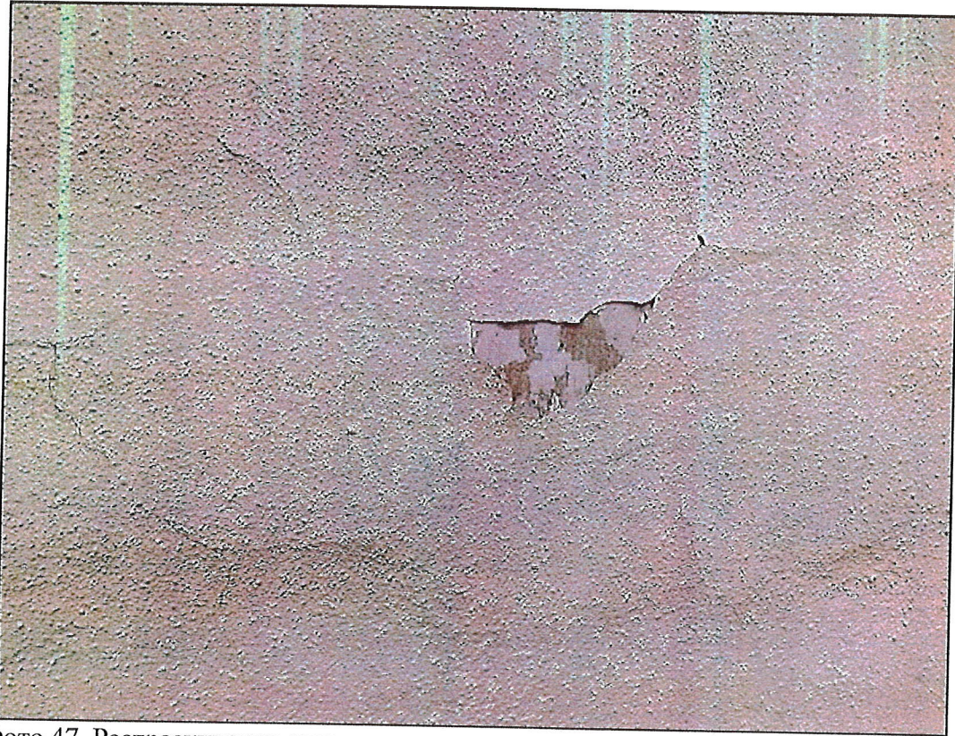
Фото 47. Растрескивание отделочного штукатурного слоя по оси «б» в осях «Б-В»
