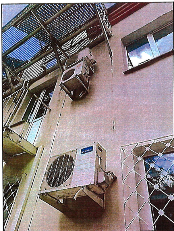
Фото 45. Следы увлажнения и сырости по оси «Д» в осях «2-3»
